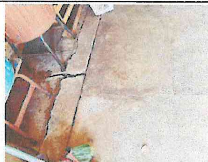
Foto 10: Partes del suelo hundidas y agrietadas.
