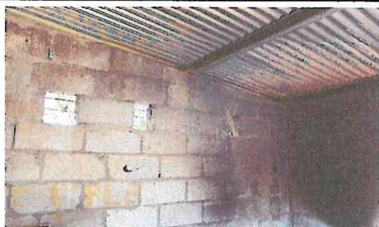
Foto 9: Cocina sin instalaciones electricas.
