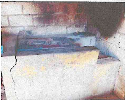
Foto 1: Cocina rural en mal estado y con grietas visibles.
