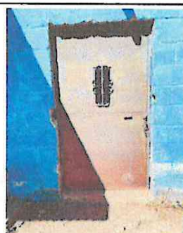
Foto 4: Puerta en mal estado, visiblemente oxidada y poco funcional.
