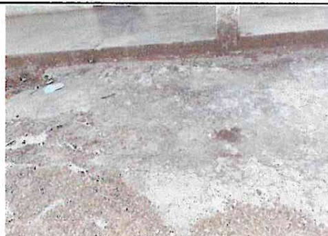
Foto 8: Loza de patio en malas condiciones.
