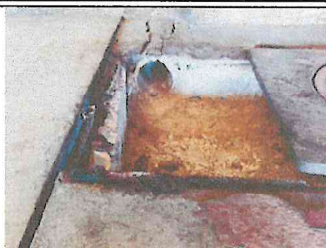
Foto 2: Chimenea colocada en mala posición, sin funcionalidad alguna.
